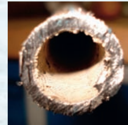
Neues Rohr nach 6 Monaten Betrieb mit ElisaWasser
